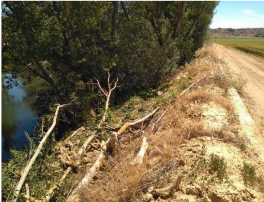
Figura 3– Vista de mota de protección en el río Esla con muro de contención junto al camino
