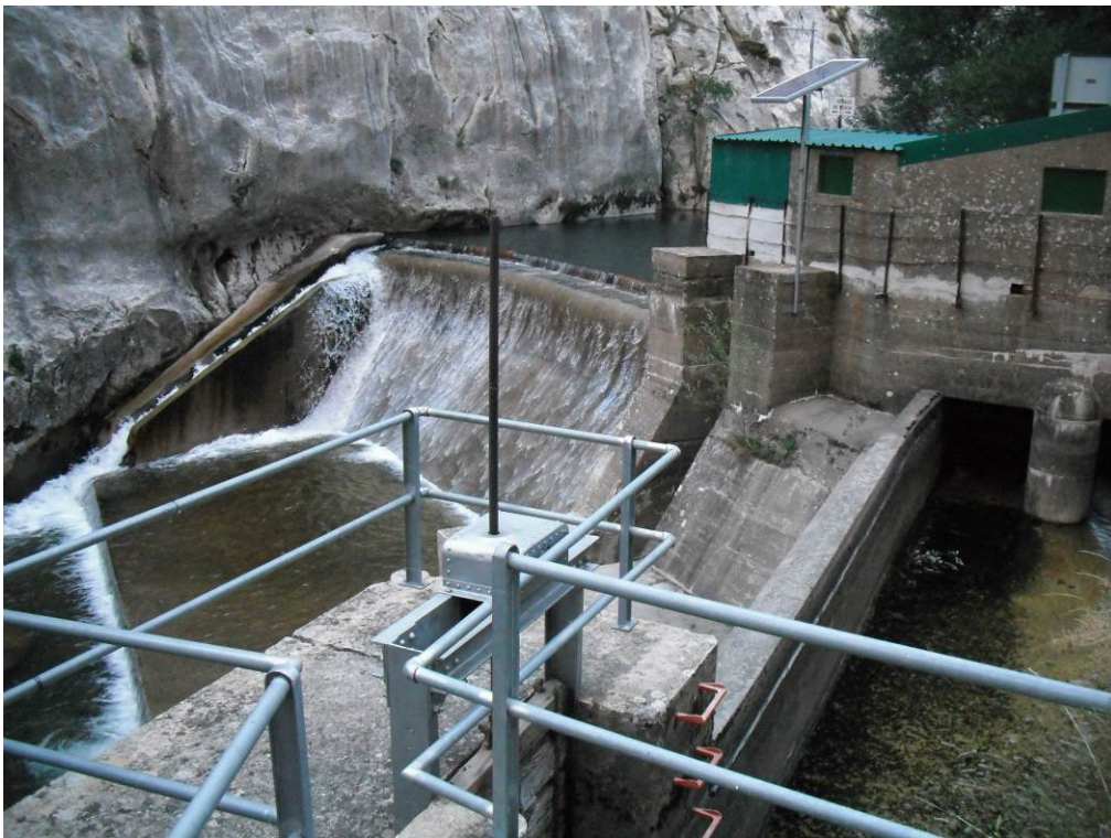
Figura 7. Río Torío. Localidad: Vegacervera. Presa de hormigón con código 4100. Es infranqueable, aunque tiene dispositivo de franqueo, pues parece que está mal diseñado.
