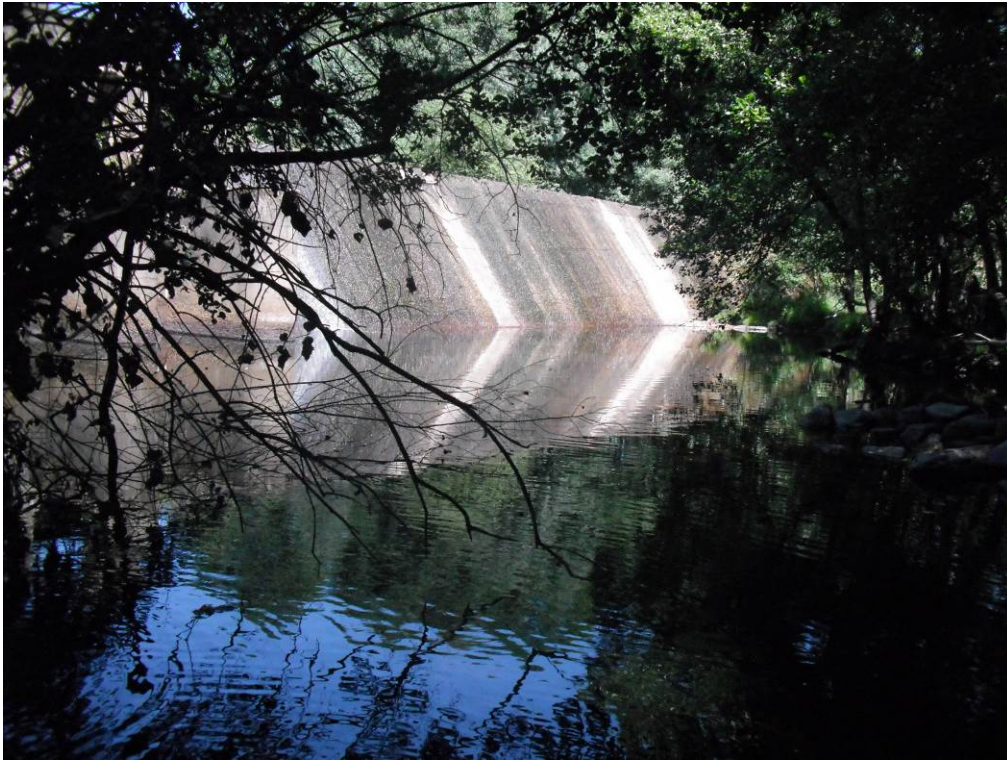
Figura 8. Río Agadón. Localidad: Serradilla del Llano. Presa con código 1003. De hormigón, infranqueable y sin escala de peces. Actualmente se utiliza para desviar agua para riego.
