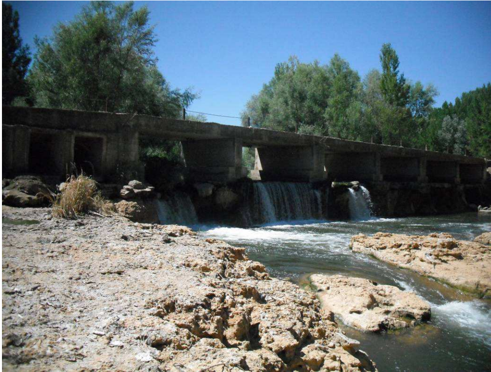
Figura 7. Azud situado bajo un puente en Olaja de la Ribera, en el río Bernesga, es infranqueable e impide la continuidad fluvial, en esta zona la continuidad de azudes y su proximidad, producen una transformación total del cauce que se convierte en una sucesión de estanques.
