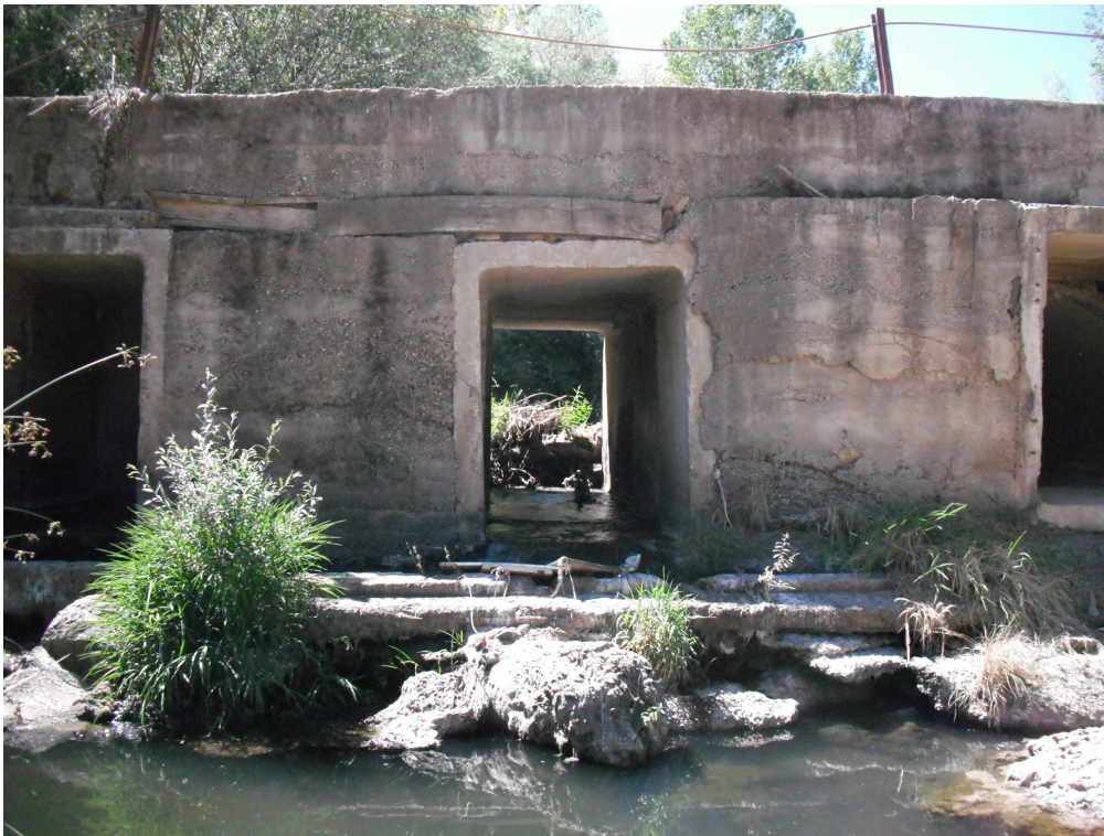
Figura 8. La solera de este puente se convierte en un obstáculo para la continuidad fluvial en el río Bernesga, se aprecian síntomas de incisión, descalzado y erosión, como consecuencia de la limitación de la carga de los sedimentos, que quedan depositados en los azudes.
