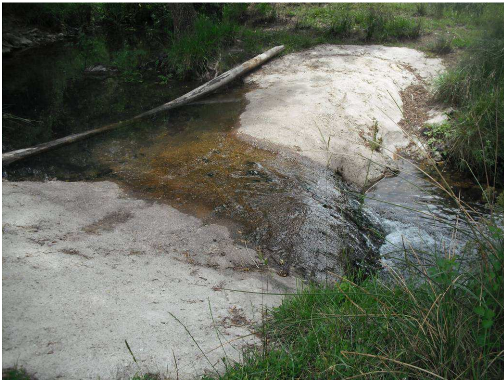
Figura 7. Azud con código 1493 en el río Casilla, sin uso, no tiene dispositivo de franqueo, es franqueable.
